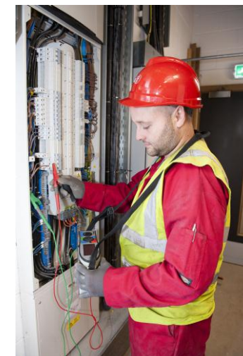
Forth Electrical Services проверяют распределительный щит Terasaki Pro-DB в арене
