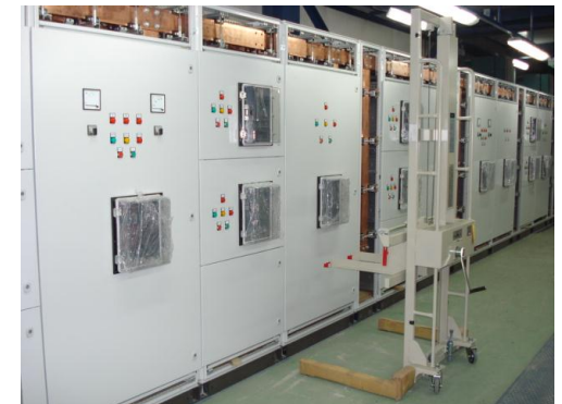
Оборудование Terasaki в месторождении in Neves Corvo
