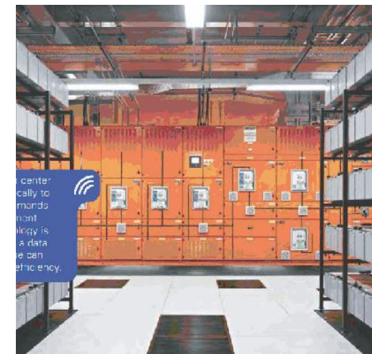
Выключатели Terasaki ACBs защищают дата центр Telehouse
